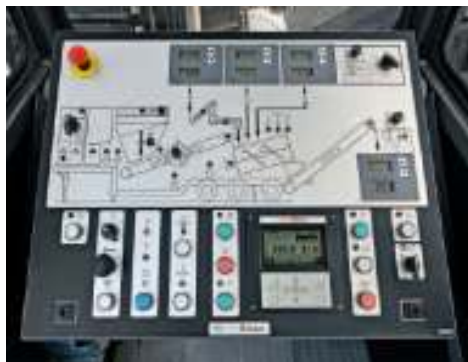
Centro de control
